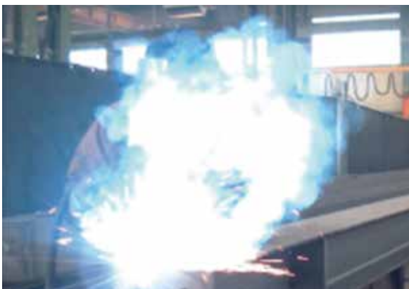
Avant: dégagement important de fumée avec l'arc conventionnel.
